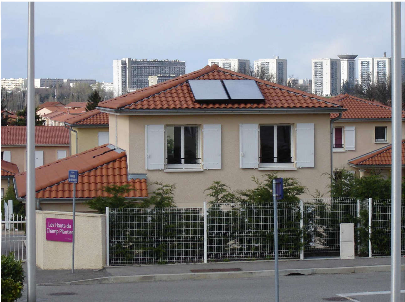
Panneaux solaires en toiture alimentant un chauffe-eau solaire, Feyzin - Champ Plantier, imp. Vilnius - 2008
